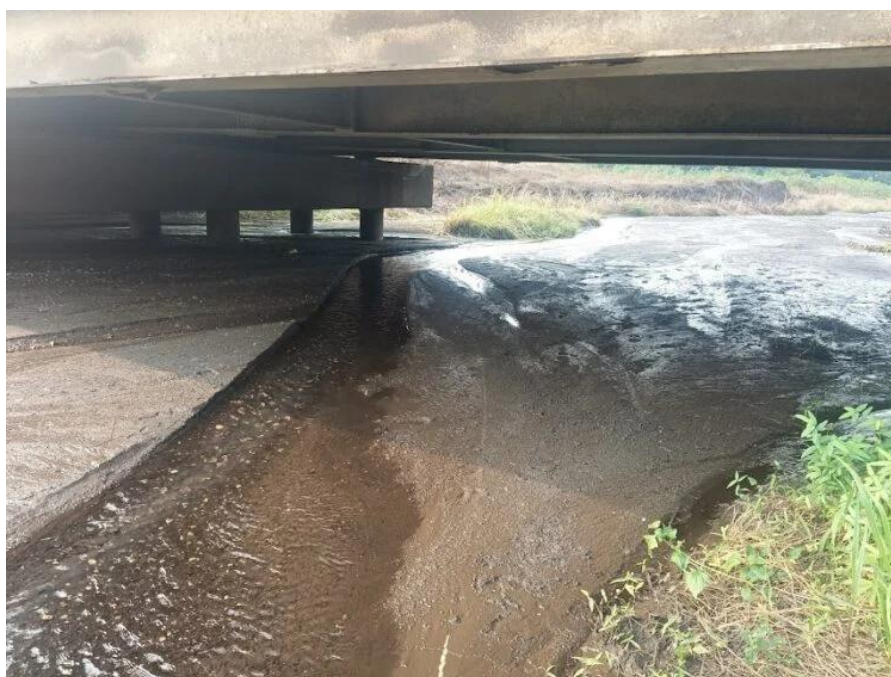
Dessous du pont sur la rivière Moulili envahi par des fines de manganèse
