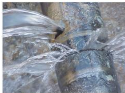
Les fuites dans le réseau réduisent notre résilience face aux chocs climatiques.
